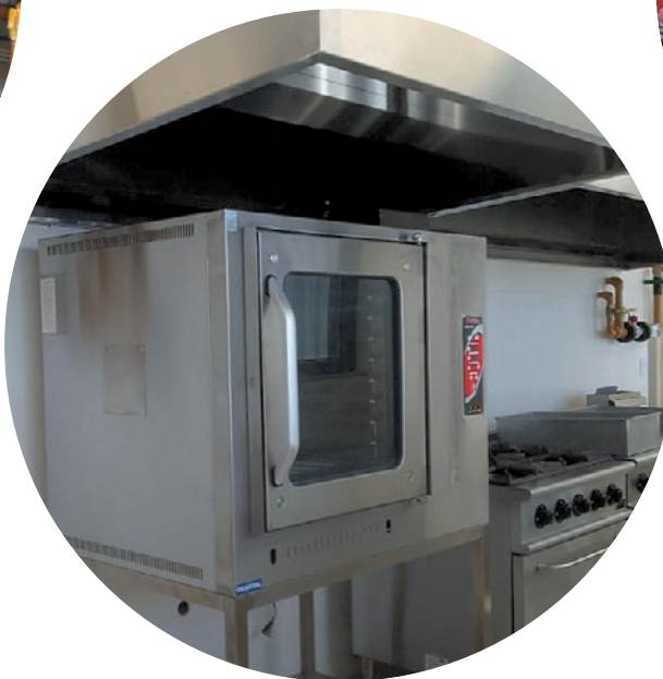
Instalaciones de Gas
