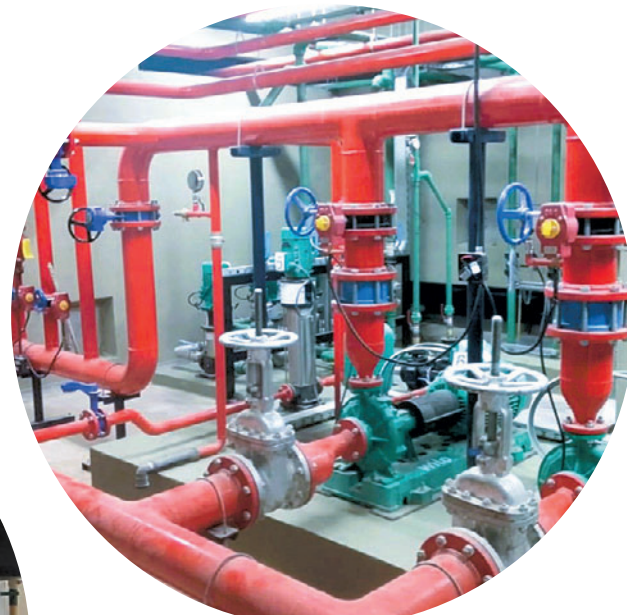
Instalaciones contra Incendio
