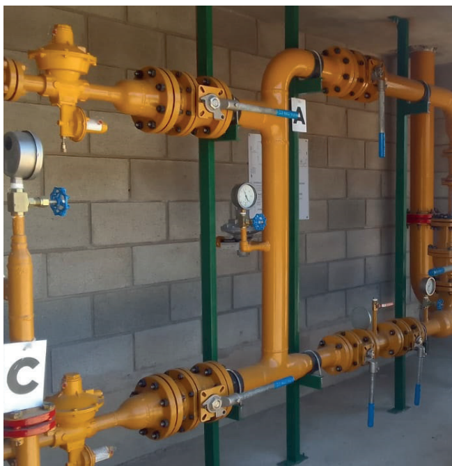
INSTALACIONES DE GAS
